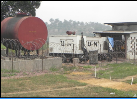
Deux générateurs 75kva
